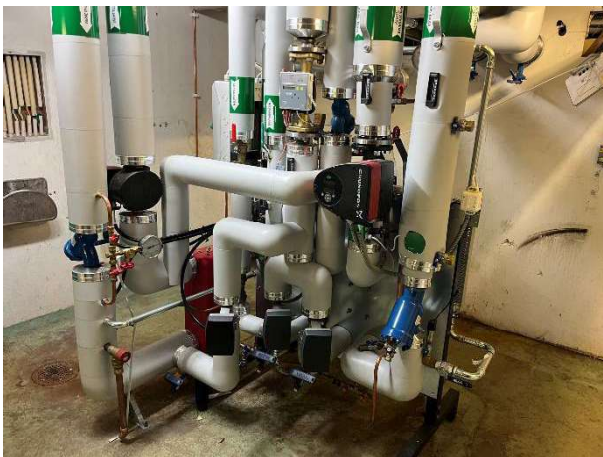
Foto, Källare (undercentral)
