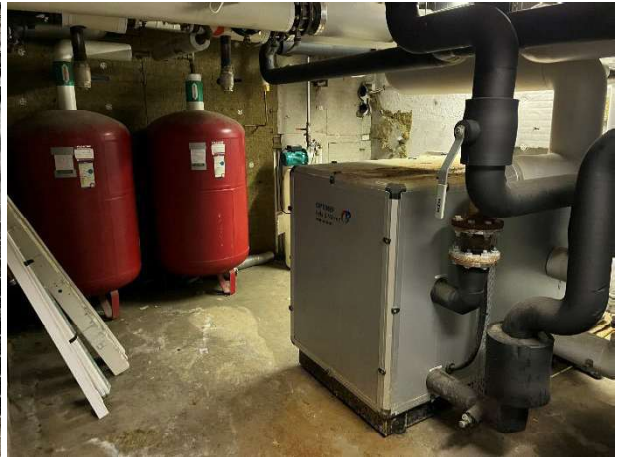
Foto, källare (värmepumpar)
