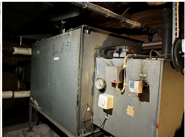
Foto, Vind (ventilationsaggregat)
