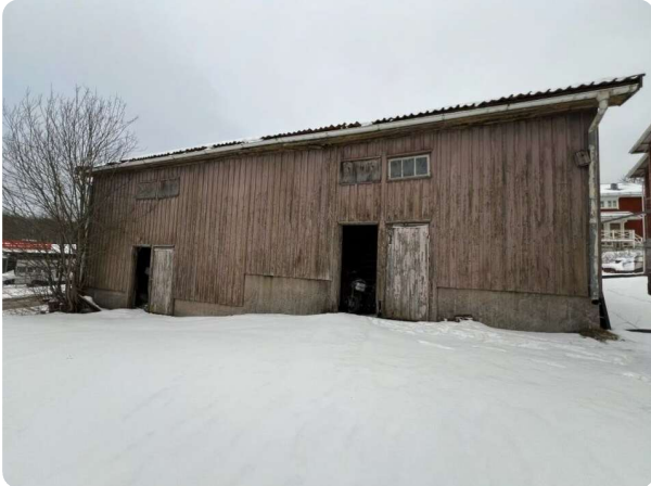
Förråd i nordvästra hörnet av tomtmarken. Dörrar saknas på fasad mot söder.
