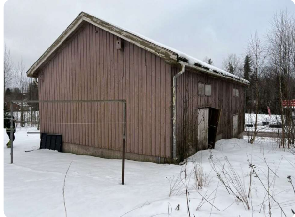
Förråd i nordvästra hörnet av tomtmarken. Dörrar saknas på fasad mot norr.
