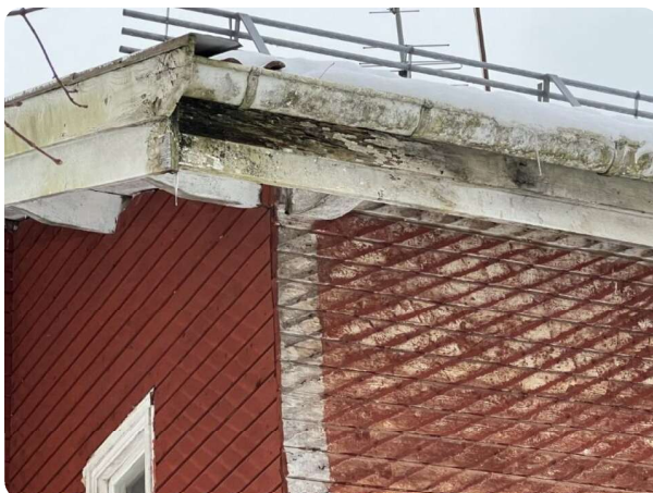
Takskada som lett till vattenskada enl. fastighetsägaren. Spår av borttagen tidigare revertering behöver målas.
