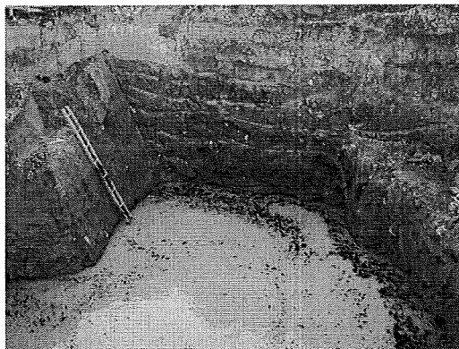
Foto 5. Kvarlämnad föroening vid nordvästra hushörnet. Föroening finns även vid stegen. Notera det rena vattnet. På vattenytan flyter petroleumsorbenten Float-adsorb.
