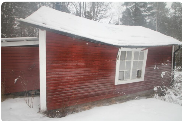
Foto garage, rödmålad träpanel, vita detaljer, skadat tak.
