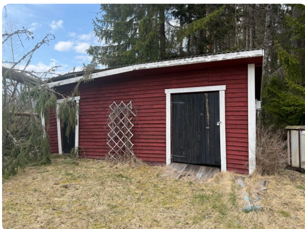
Uthus med skador från fallande gran
