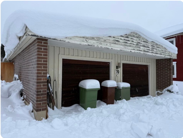
Garagebyggnad. Tegelfasad med slitna trädetaljer i vitt.
