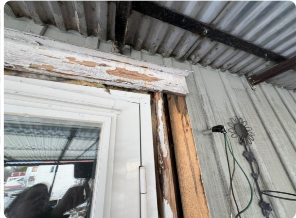
Dörrfoder saknas på dörr till terrass, övervåning
