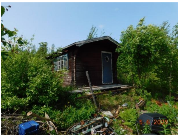
Foton, fallfärdiga byggnader.
