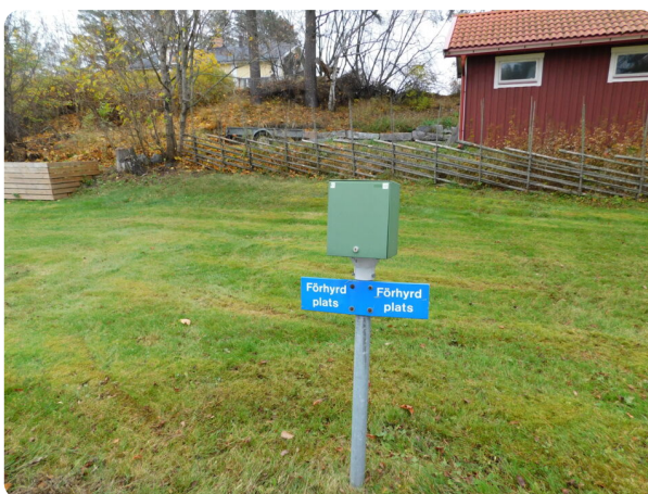
Eluttag för motorvärmare.
