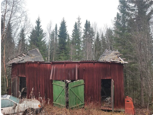
Förrådsbyggnad där taket rasat
