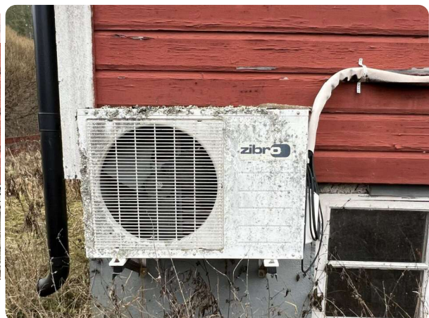
Värmepump Zibro (funktion ej verifierad)
