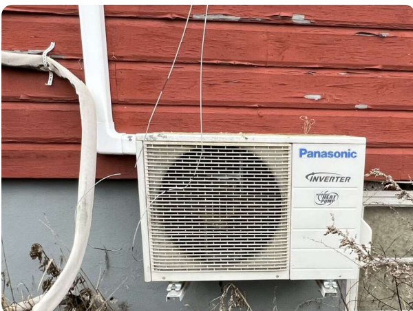
Värmepump Panasonic (funktion ej verifierad)
