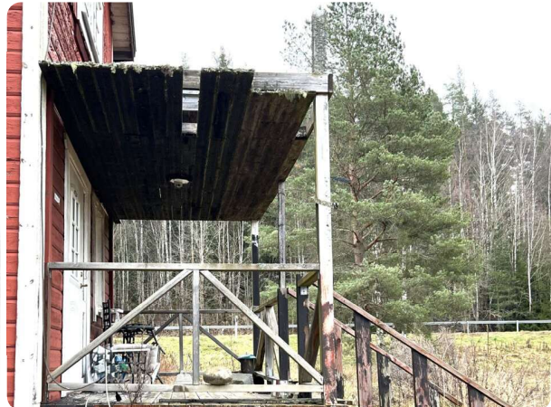
Veranda i behov av reparation
