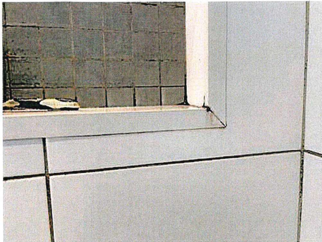
Vid stickprovsmässig utförd fuktindikering indikerades förhöjd fukt i anslutning till hyllor i duschens vägg.
