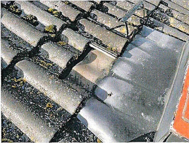
Plåt med brister till yttertaket.
