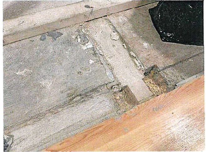
Källaren har påbörjad renovering. Mot betongplatta finns plastmattor och ingjutna regler som rekommenderas att tas bort.
