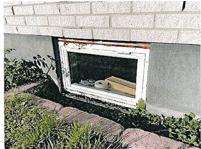
Fönster saknar fönstrebleck mm är ej helt färdigställt.
