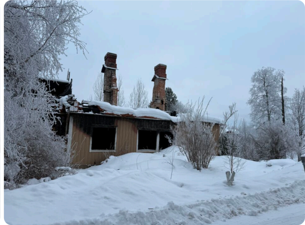
Värderingsobjektet. På tomten står en totalskadad byggnad.
