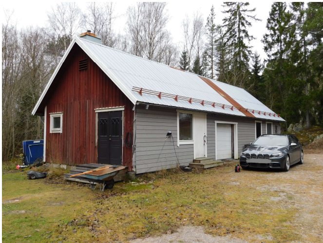
Foto, övrig byggnad, förråd, fasad delvis utbytt.
