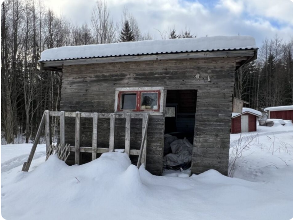
Förråd. Dörr saknas Byggnaden skev.
