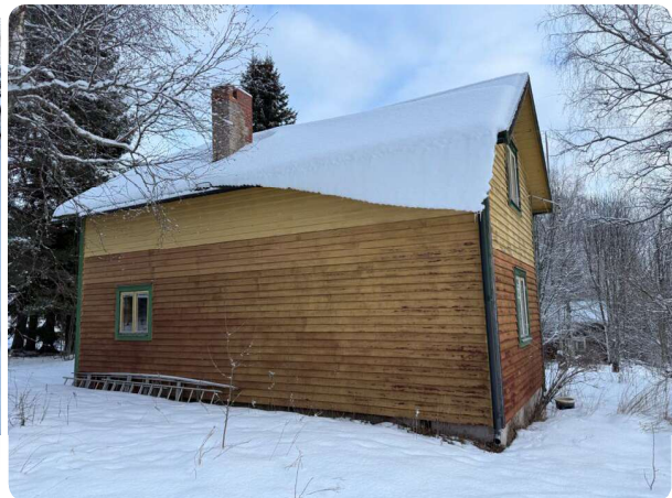
Bostadshusets baksida. Gulmålad träpanel i eftersatt underhåll
