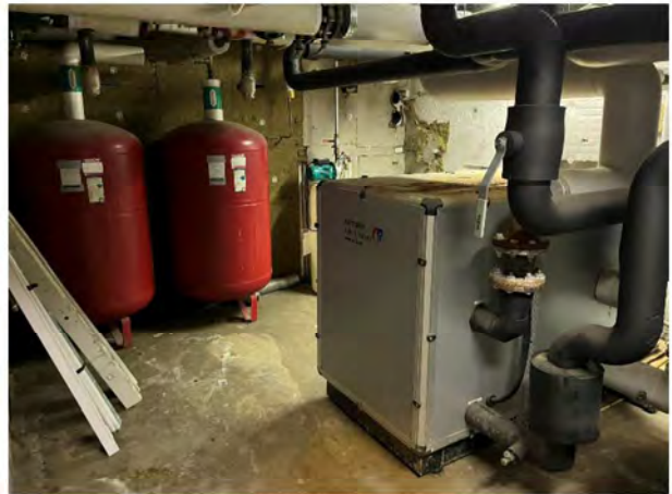
Foto, källare (värmepumpar)
