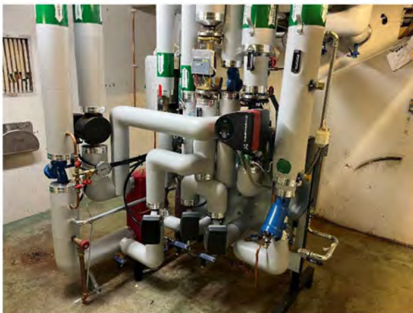
Foto, Källare (undercentral)
