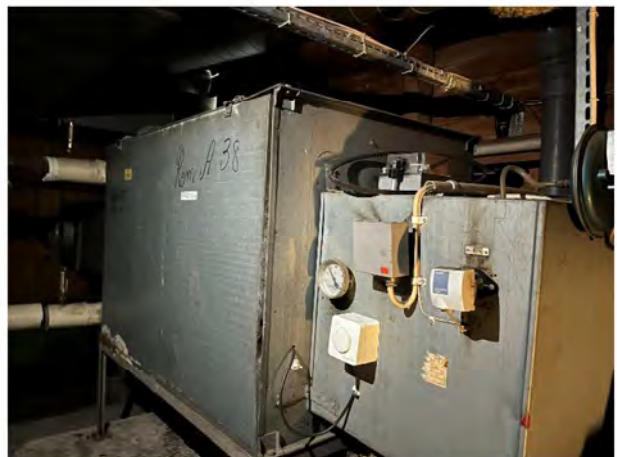
Foto, Vind (ventilationsaggregat)
