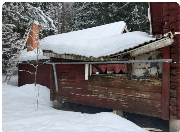
Baksidans borte del där del av taket rasat in och fönster saknas.
