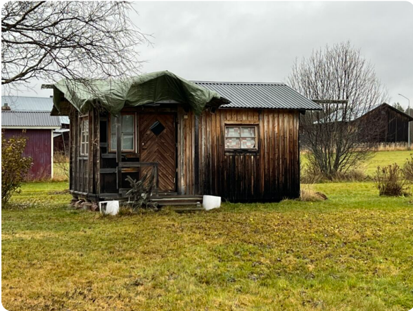
Friggebod. Avstannad färdigställning. Presenning över takyta utan takplåt där vatten läckt in.
