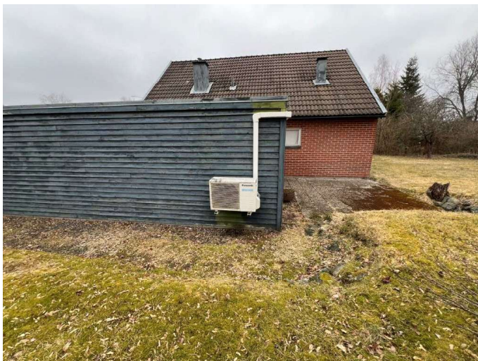
Foto, luftvärmepump monterad på carport/förråd
