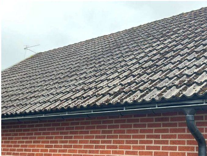
Foto, betongpannor, mosspåväxt
