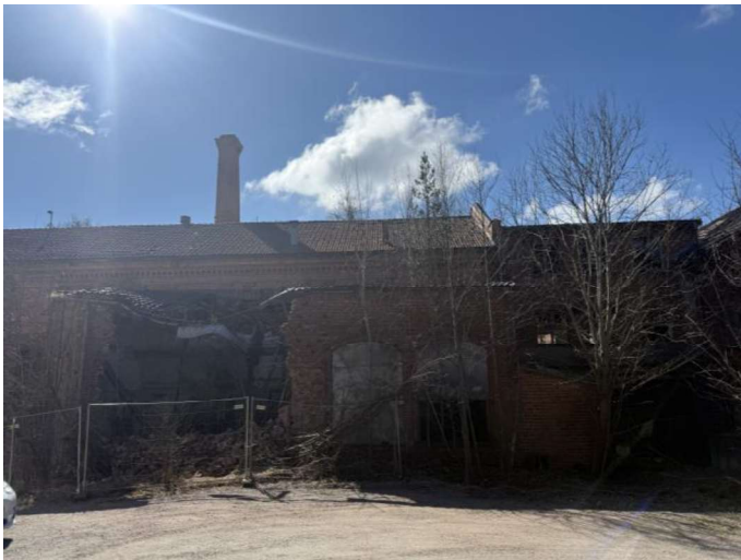
Foto, Byggnad i fallfärdigt skick.
