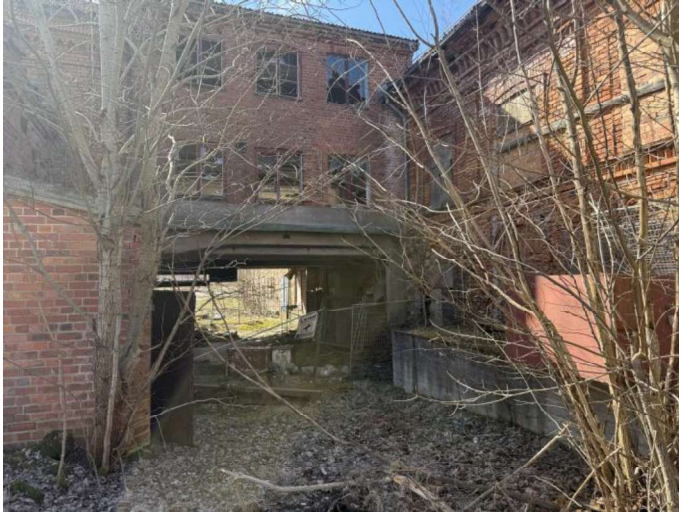
Foto, Byggnad i fallfärdigt skick.
