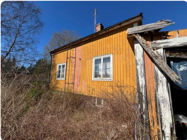
Bostad sedd från sydost. Del av garagehörn med ruttna trädetaljer.
