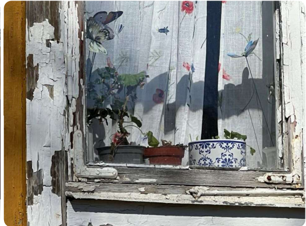
Kraftigt eftersatt utvändigt underhåll
