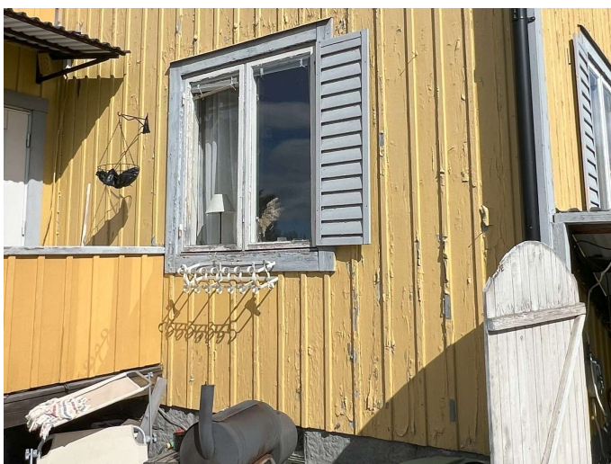
Foto. Entrésida mot söder. Eftersatt utvändigt underhåll.
