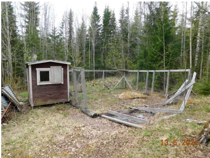
Foto, höns hus med staket som rasat.
