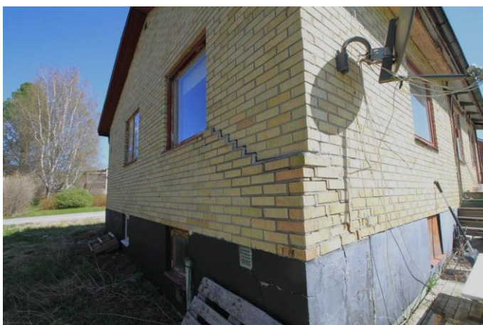
Foto huvudbyggnad spricka i fasad.
