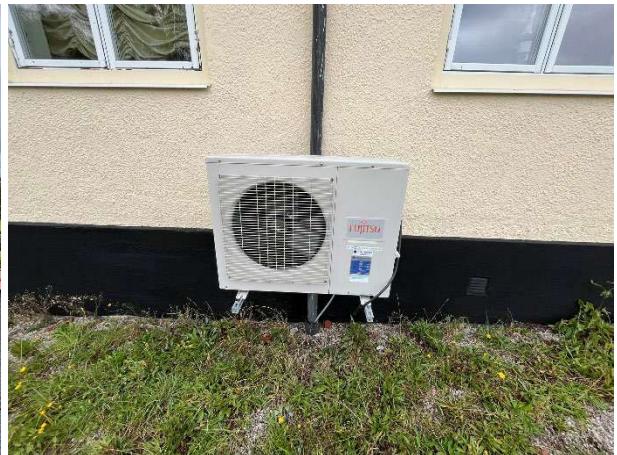
Foto, fasad (luft/luft värmepump)
