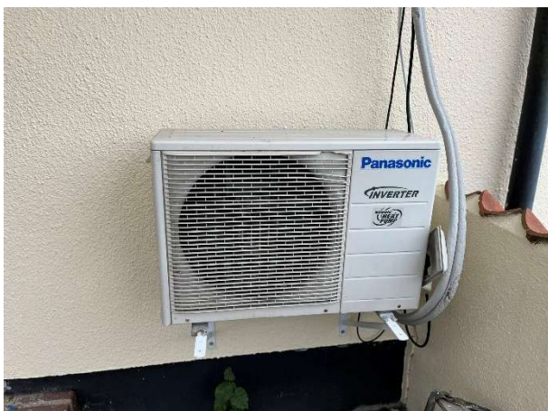
Foto, fasad (luft/luftvärmepump)
