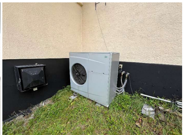
Foto, fasad (luft/vatten värmepump)
