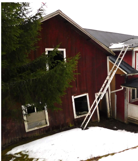
Foto, byggnad 2, framsida, förfallen byggnad (fd magasin) i anslutning till huvudbyggnad.
