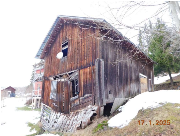
Foto, byggnad 2, baksida, förfallen byggnad (fd magasin) i anslutning till huvudbyggnad.
