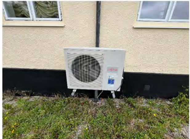
Foto, fasad (luft/luft värmepump)
