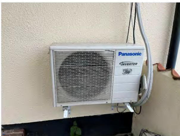
Foto, fasad (luft/luftvärmepump)
