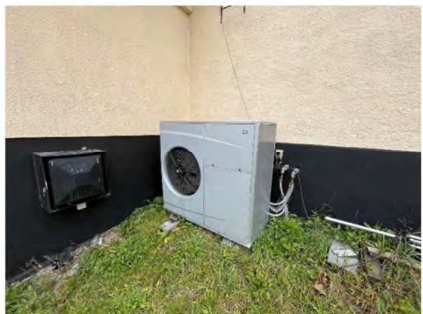
Foto, fasad (luft/vatten värmepump)
